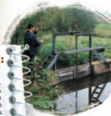
Ouvrage de régulation hydraulique. Vanne simple Vautelle. Marais de la Poupinière.
