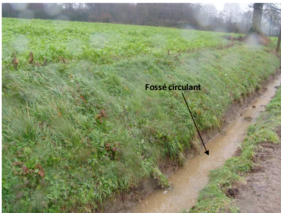
Photo 15 : Fossé circulant véhiculant des eaux marron chargées en particules de sols provenant d'une parcelle située en amont (photo prise hors BV lors de l'hiver pluvieux de 2013/2014)
