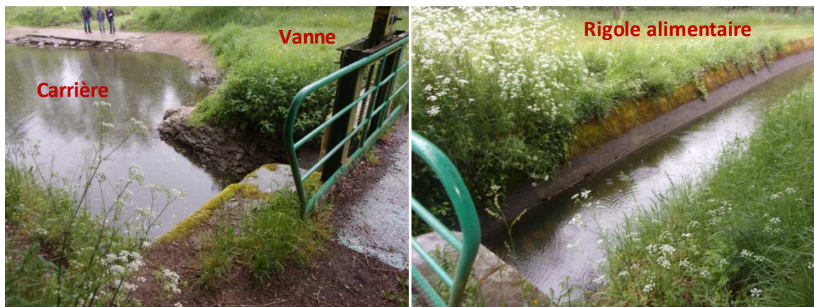
Photo 8 : Une vanne permet la régulation du passage des eaux vers la rigole alimentaire du canal de Nantes à Brest
