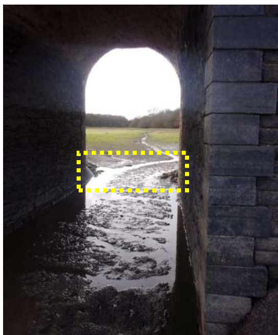
Actuellement, aucun système ne permet une régulation des débits.
